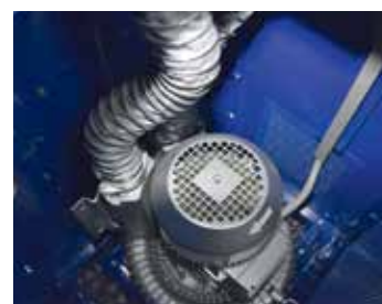
Вентиляторная камера с вихревым вентилятором
