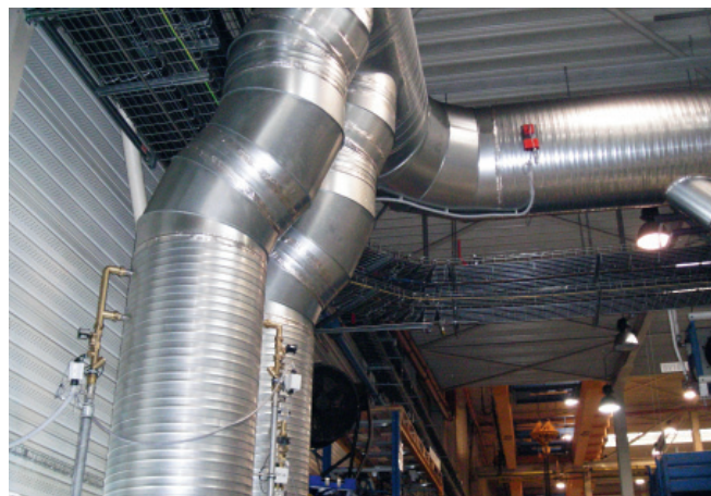
Встроенный в воздуховод датчик и система искротушения
