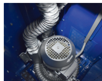
Вентиляторная камера с вихревым вентилятором
