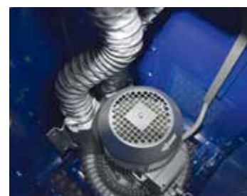
Вентиляторная камера с вихревым вентилятором
